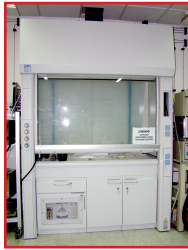
Campana para manejo de sustancias tóxicas y corrosivas
